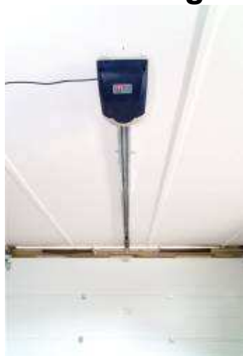
Fig. 9.1 Ferdig montert motor
